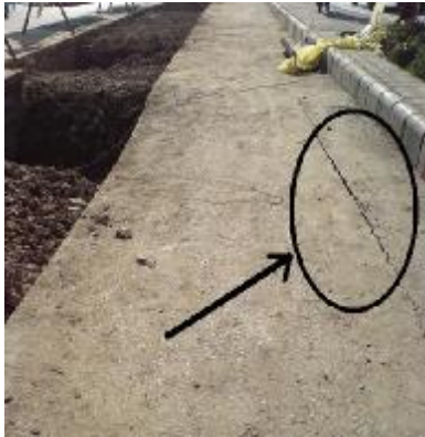
شکل(10): نشست آسفالت مجاور در اثر گودبرداری در مجاور آن
