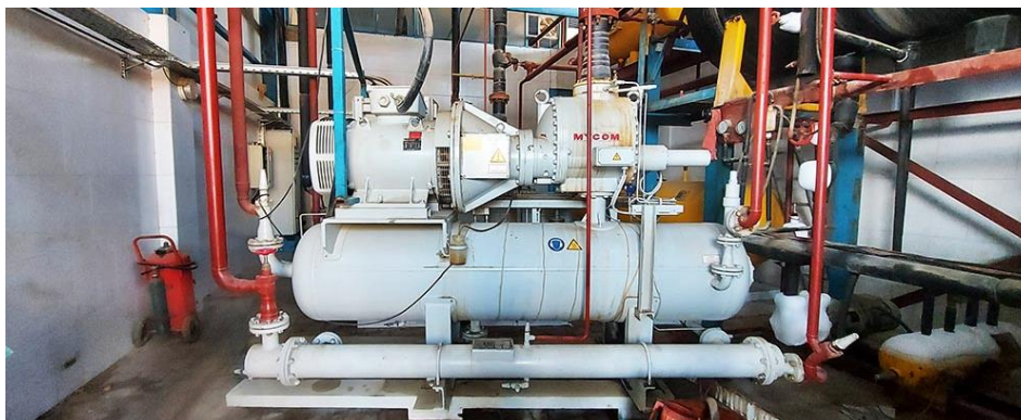
شکل-3: تصویر کمپرسور MYCOM ساخت ژاپن.
