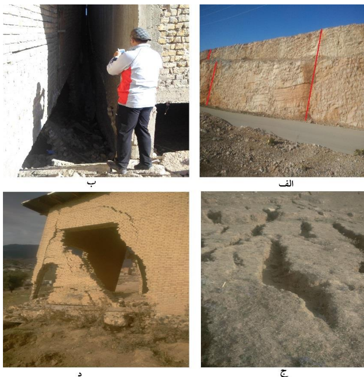
شکل ۱۲: الف: تصویر گسل‌های عادی سنگ بستر آهکی در پشت تاج لغزش و در مجاورت سد، ب: ظهور چشمه در زیرزمین منازل مسکونی، ج: ترک و شکاف‌های عرضی در خاک رس منطقه و د: کف بالآمده ساختمان ورزشگاه، که سبب ریزش دیوار و سقف شده است.
