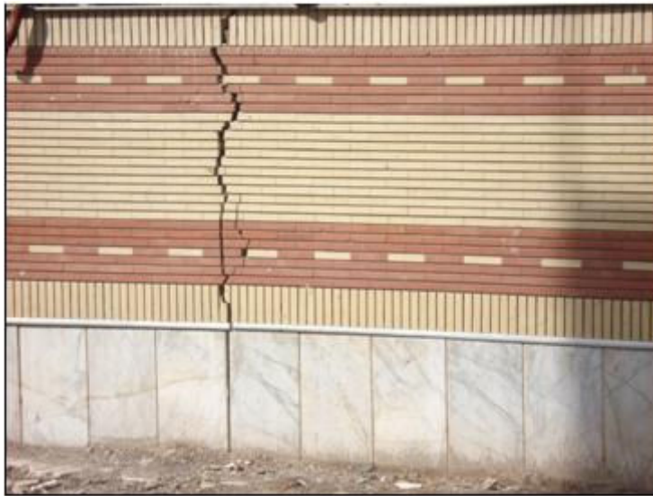
شکل ۳- ترک خوردگی ساختمان ناشی از نشست زمین در خیابان اندیشه
